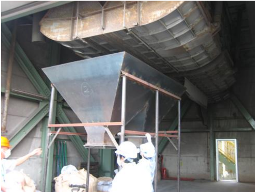
焼却飛灰の排出（フレコン バッグへの詰め込み）
