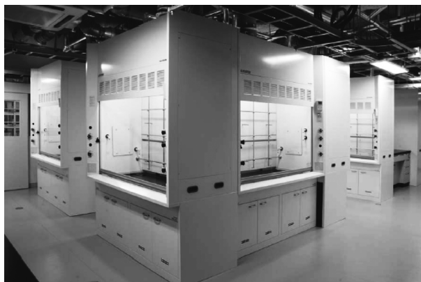
写真 8 VAV 給気空調システムに対応したスクラパー装備ド ラフトチャンバー
