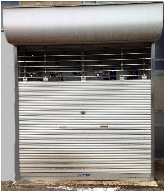
屋外水素(可燃性)キャビネット
